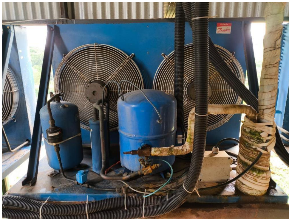
Figura 5 – UNIDADE CONDENSADORA DANFOSSHCM0649 380V FRIF 5.5HP
